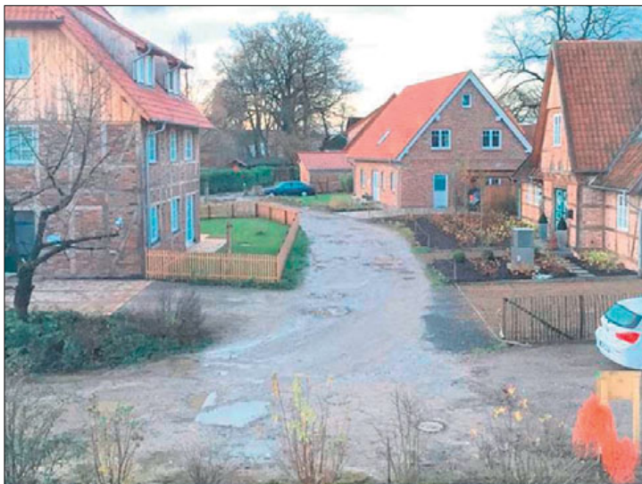
Ein massiver Kritikpunkt der Anlieger gegenüber ihrem Vertragspartner Erik van der Vorm ist der Zustand der Baustraße. Bei Regen gleicht sie einer Seenplatte, Löcher werden nicht verfüllt. Diese vor einigen Wochen erstellte Aufnahme zeigt sogar noch einen vergleichsweise guten Zustand, so die Anlieger bei einem Ortstermin. Foto: Privat
