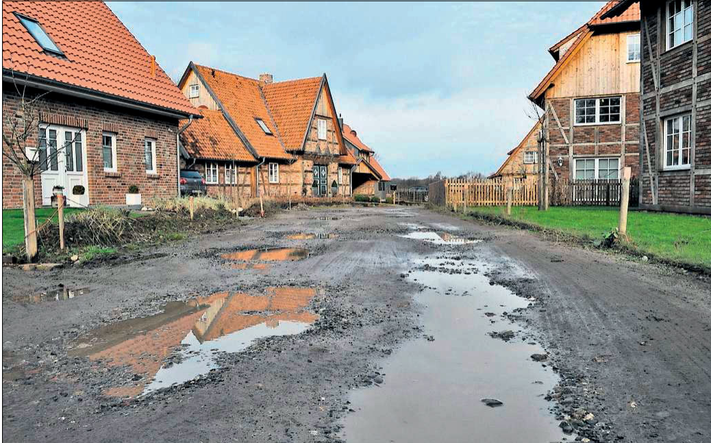
Nach wie vor ist die Straße Rebhuhnfeld in Scherenbostel eine Baustraße – sehr zum Ärger von Anliegern.
